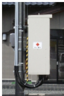
高圧契約のお客様設備 (柱上設置型小型変電設備)
