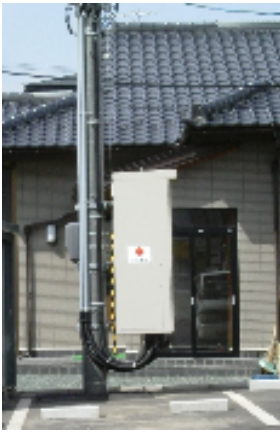
柱上設置型高圧受電設備
